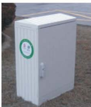
3、电缆分支箱(π接箱,分线箱)
