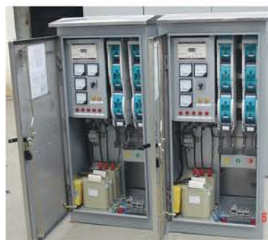
4、工业配电及控制(成套设备控制柜、箱,生产线配电柜及控制柜)
